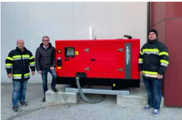
neue Notstromversorgung für das Rüsthaus 2021
